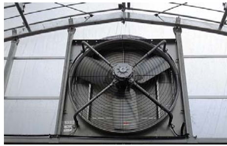
ハウス換気用大型換気扇
